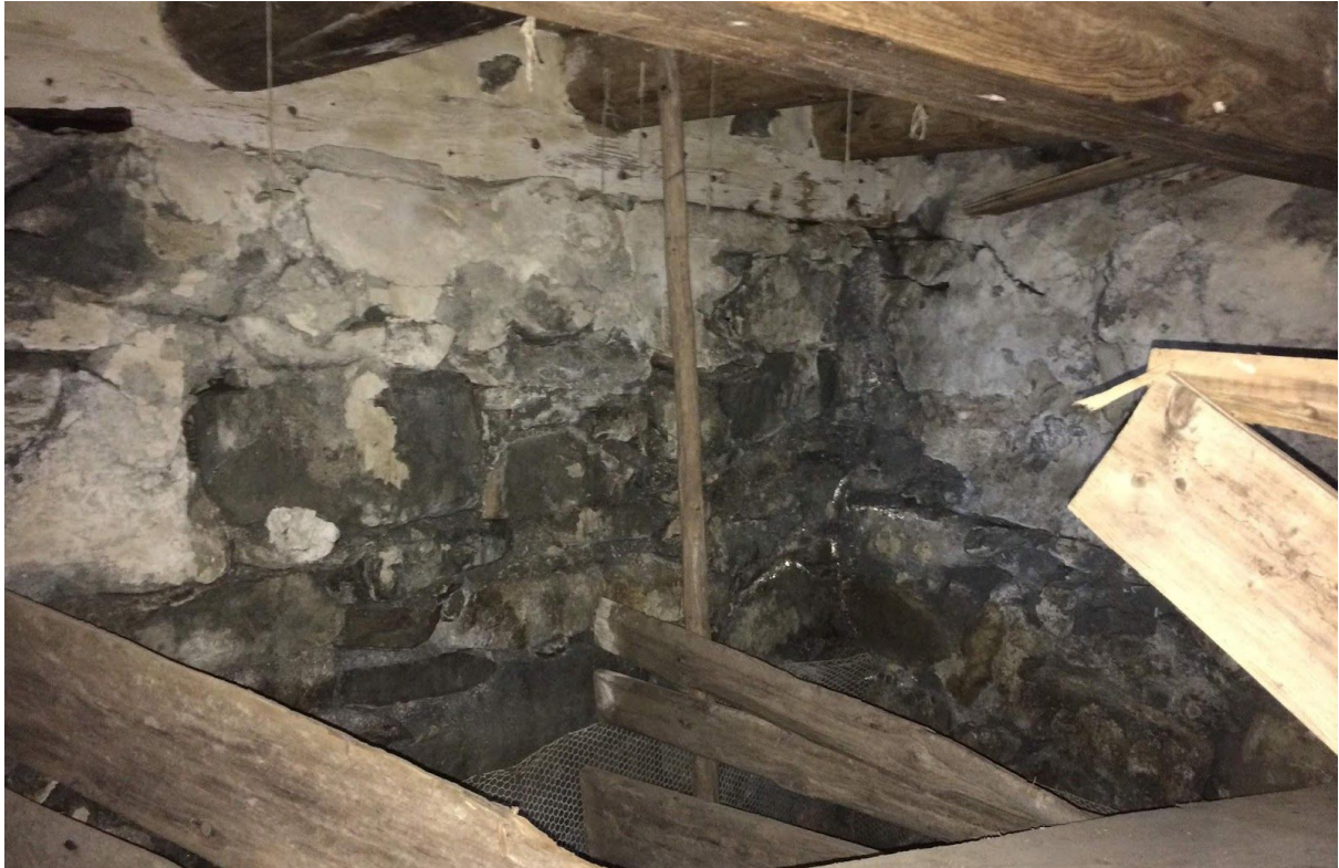
Kjellerens sørøstre hjørne. Deformerte vanger og spor etter fukt.
