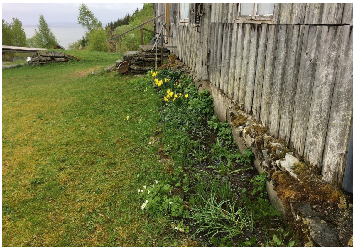
Under bindingsverksdelen er muren presset svært mye ut av posisjon i det nordvestre hjørnet. lengst øst har muren trolig opprinnelig murliv i behold. Denne muren kan være oppført med en kraftig påstøp av betong utvendig. hele muren har vridt seg ut av posisjon vestover mot hjørnet.
