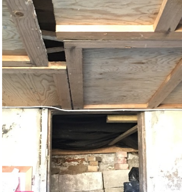
Råte i gulv, og åpen isolasjon under gulv i jordkjeller
