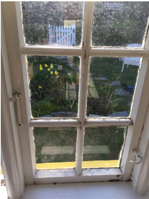
Eldre vinduer med enkle glass. Usikkert om disse må skiftes eller kan rehabiliteres.
